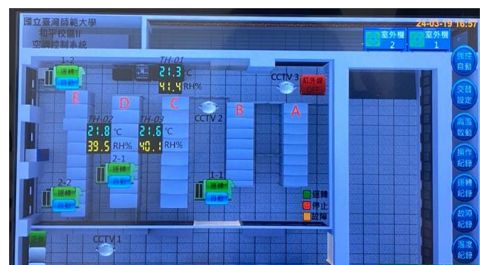
和平校區機房空調運作即時狀態畫面
